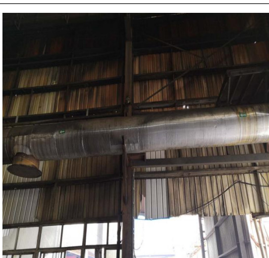
煤气输送管道
