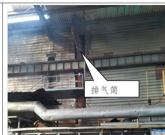
天然气退火炉排气筒
