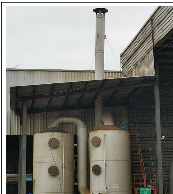
混酸酸雾废气处理设施
