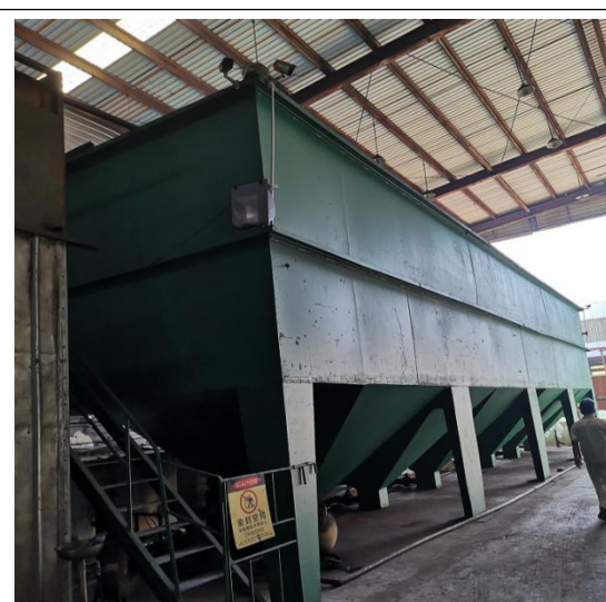
废水处理设施
