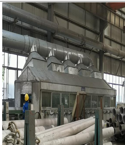
打磨机组废气处理
