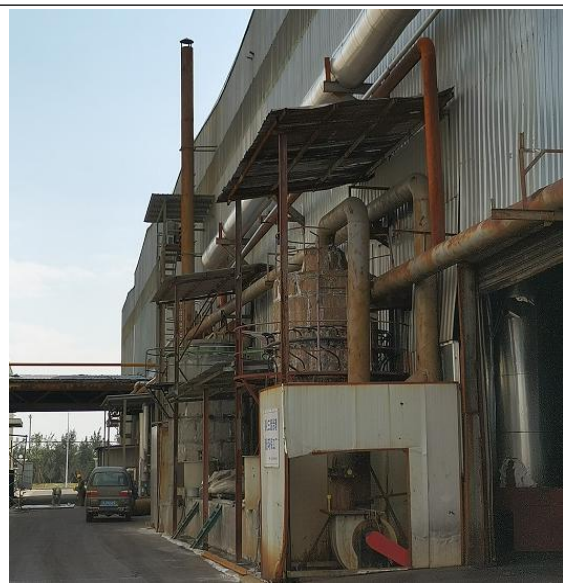
煤气加热炉、退火炉废气处理设施
