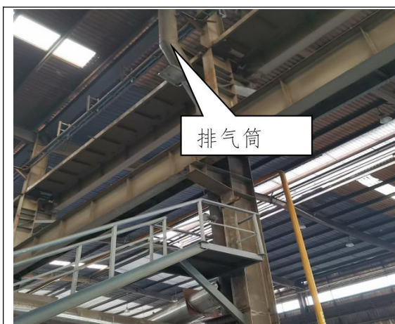
A6车间60天然气排气筒
