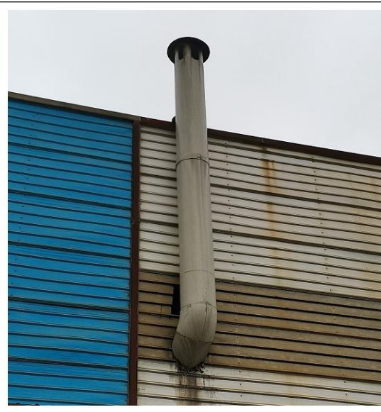
冷轧油烟排气口
